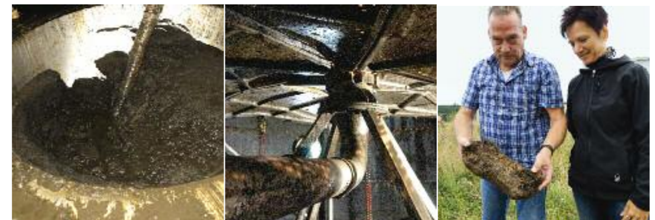
Ganz frei von Rückständen laufen die Bioreaktoren nicht, die regelmäßig einer Revision unterzogen werden müssen. Dabei kommen auch ganz harte Brocken zu Tage, wie Anlagenleiter Frank Steinberger hier Martina Hübner zeigt.
