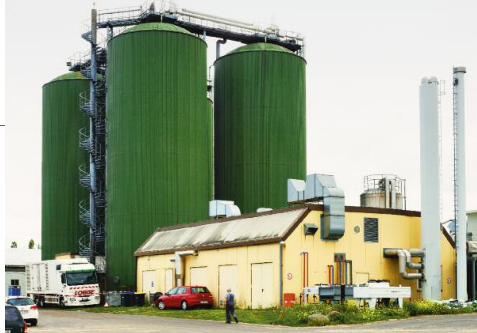
Die Biogasanlage Finsterwalde mit ihren vier Reaktoren ist ein gutes Beispiel für funktionierende Kreislaufwirtschaft und Ressourcenschonung.
