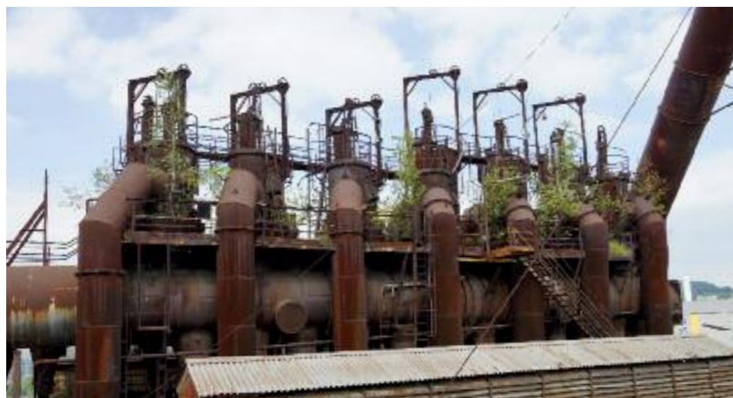
Blick auf die Trockengasreinigungsanlage III.
