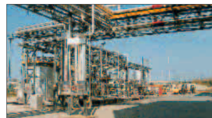
Das Tanklager für flüssige Sonderabfälle und Altöle.
