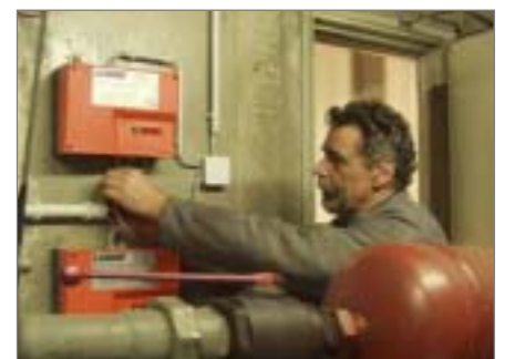
))) Anschluss der Dauerüberwachung.
